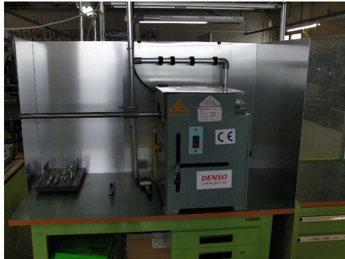
飛散防止衝立の全景
